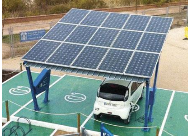
Charging point in Alcalà de Henares. Source: Ambient@
